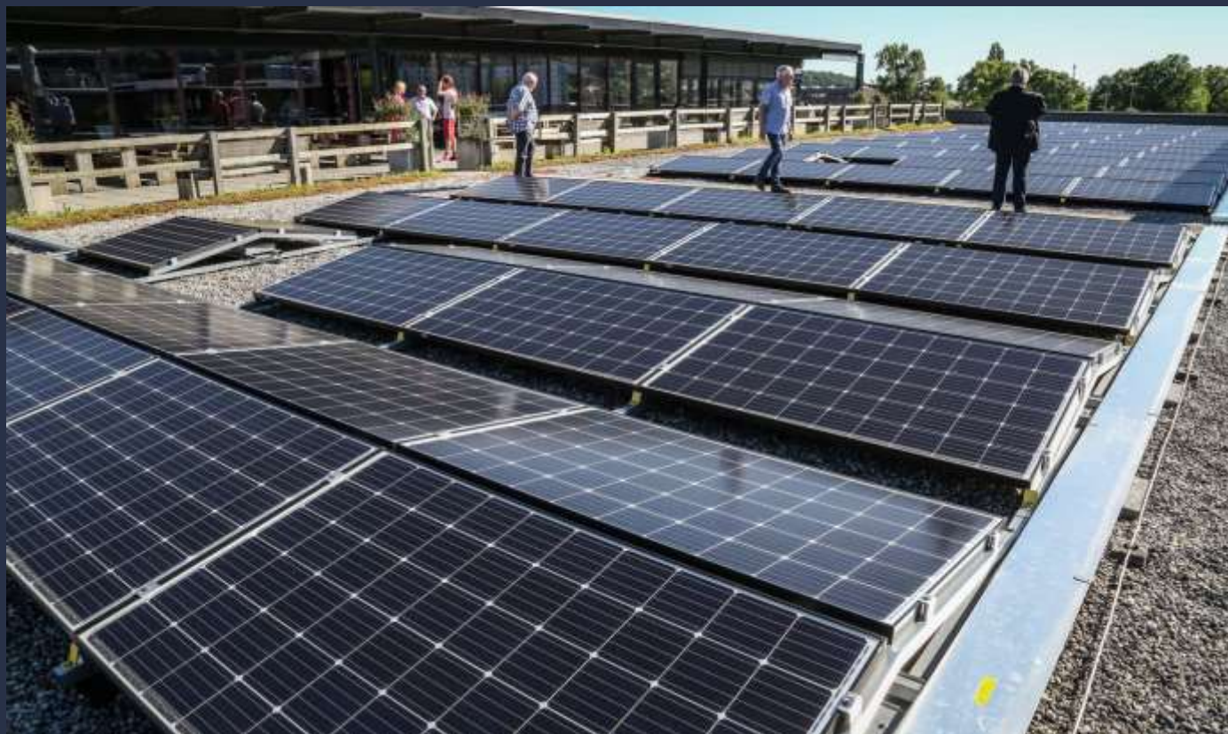
Installation Solar Planet, chez MPS par Soleol SA
