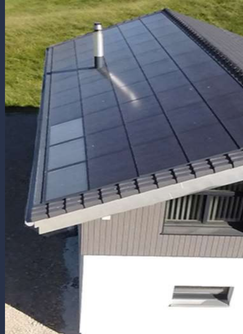
Toiture solaire par Solstis, 2-3 CHF/W 10-15 cts/kWh
