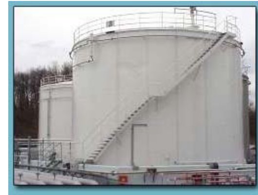
Cuve de stockage (Source : SAPPRO S.A.)
